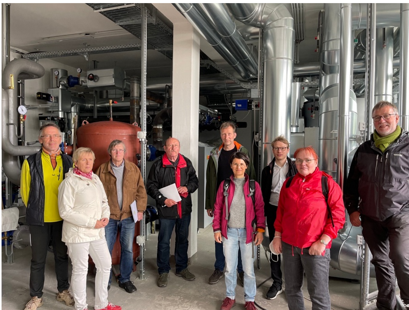
In der Energiezentrale, Ökosiedlung Friedrichsdorf: Von links:
